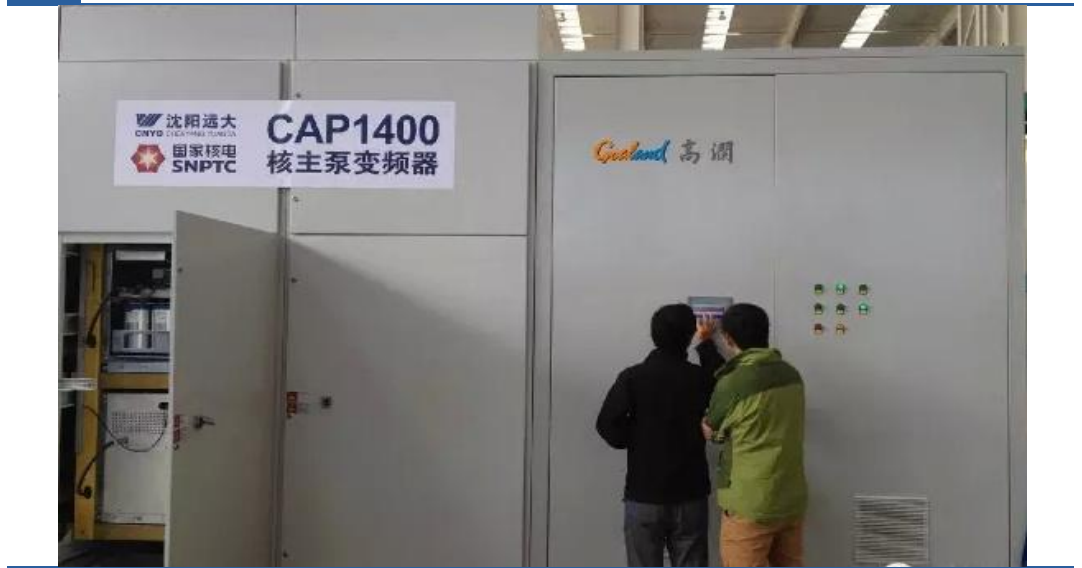
图 9: 中标 CAP1400 主泵变频器水冷设备
