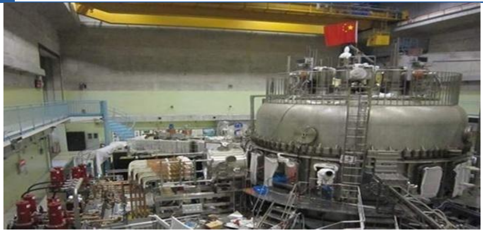
图 8: 配套中科院聚变装置水冷系统
